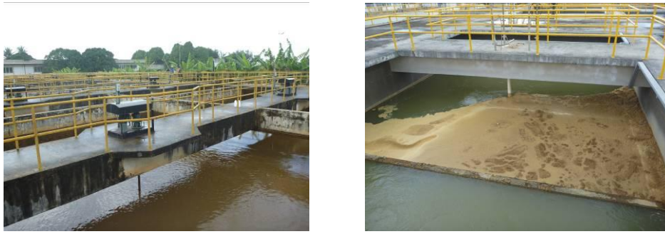
Figura 2: Tanques de floculação da ETA-1 e ETA-2.
